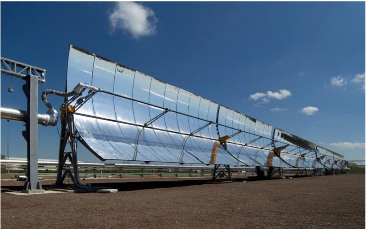
Collettore parabolico lineare (Fonte: Archimede Solar Energy- www.archimedesolaenergy.com )
